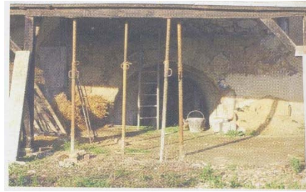
le four à chaux (1857), en entrée de bourg, le long de la RD 10
